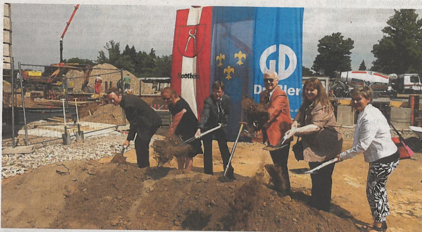
Die künftige Kita, für die nun der Spatenstich erfolgte, wird Platz für drei Krippen- und eine Elementargruppe bieten.
