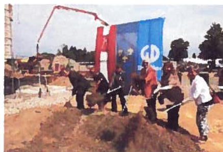
Die künftige Kita, für die nun der Spatenstich erfolgte, wird Platz für drei Krippen- und eine Elementargruppe bieten. Foto: hbz/Jörg Henkel
