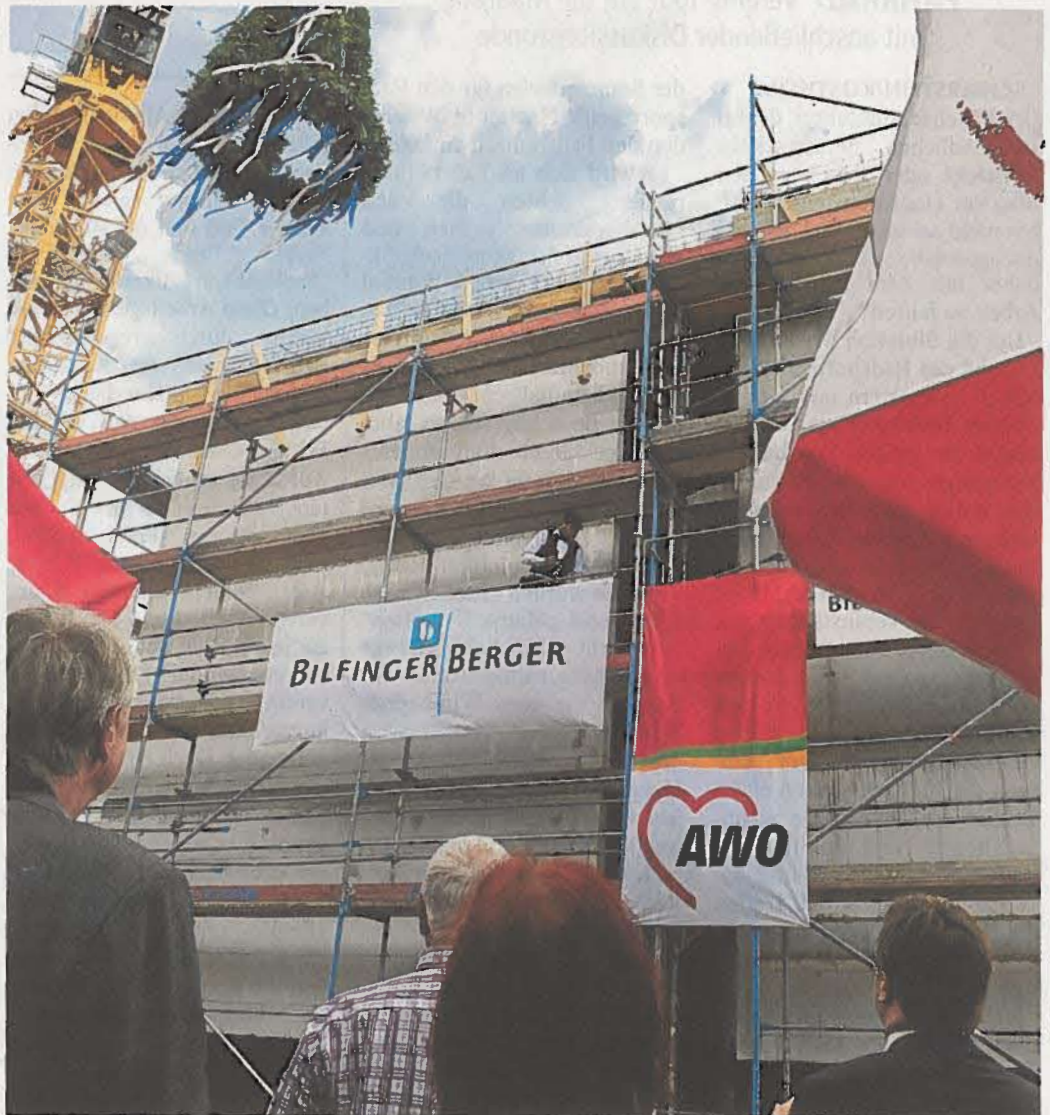
Der Richtkranz hängt über dem Rohbau beim Richtfest des neuen Altenhilfezentrums der Arbeiterwohlfahrt in Bierstadt.
