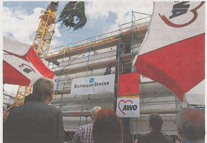
Der Richtkranz hängt über dem Rohbau beim Richtfest des neuen Altenhilfzentrums der Arbeiterwohlfahrt in Bierstadt. Foto: wita/Paul Müller
